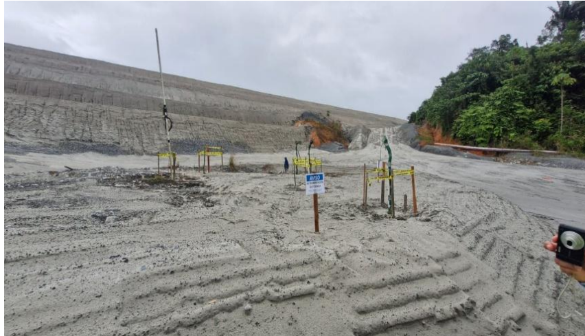
Fotografía 7-65 Monitoreo de taludes de la IMR, mediante piezómetros e inclinómetros
