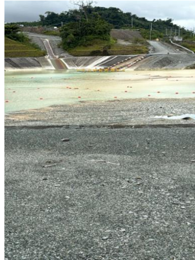
Fotografía 7-59 Poza 2 - Sistema de bombeo y canales revestidos
