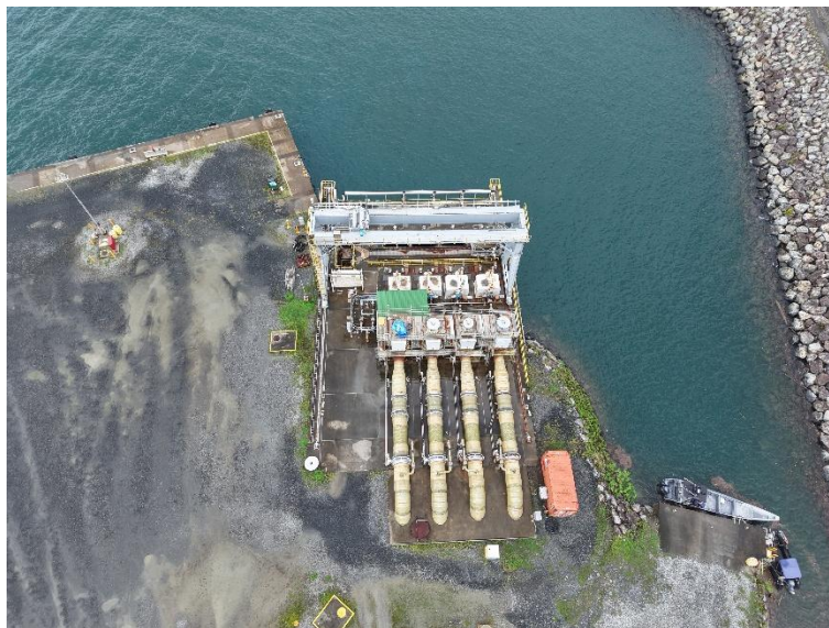
Fotografía 7-130 Panorámica sector bombas de captación agua de mar
