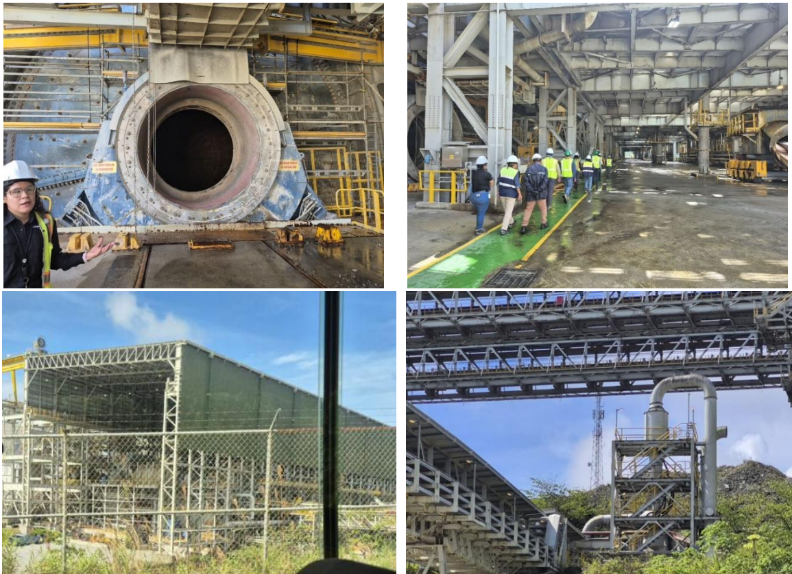
Fotografía 7-25 Revisión visual de localización y estado de área de procesos, sistemas de trituración/molienda
