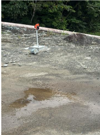
Fotografía 7-52 Instrumentación Topográfica – Dique Poza 12
