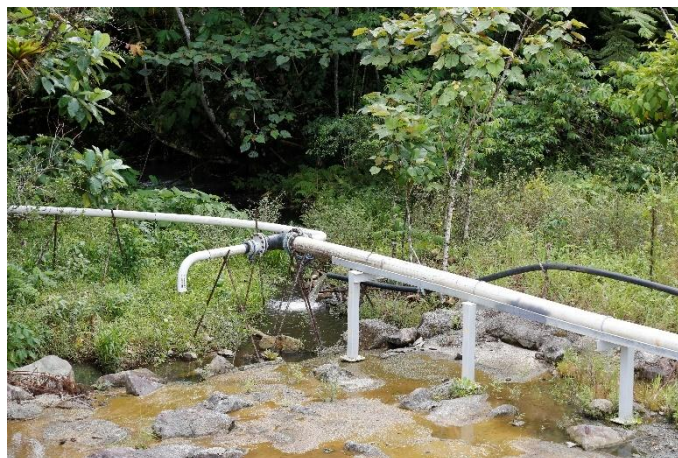
Fotografía 7-51 Zona de surgencia en el pie del Talud Poza 12
