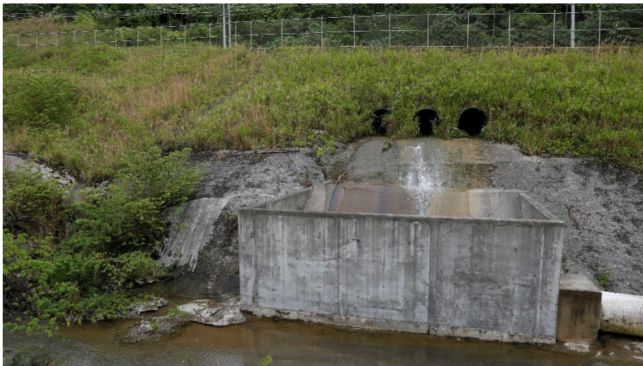
Fotografía 7-57 Estructura de descarga de aguas de no contacto
