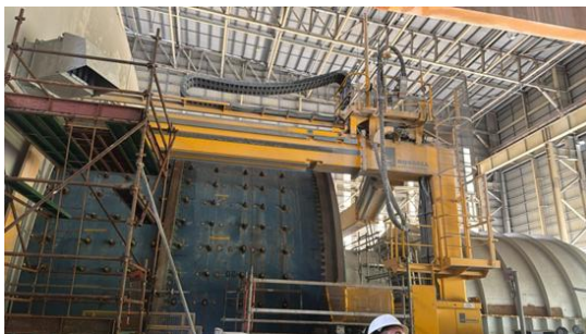
Fotografía 7-22 Molino SAG con equipo Russell Mineral Equipment
