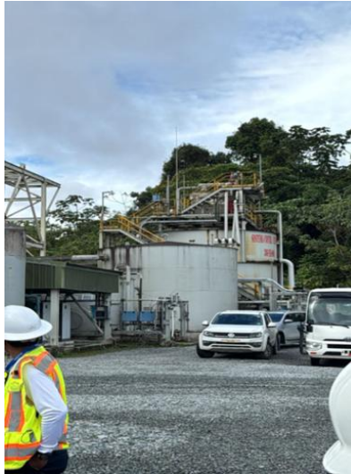
Fotografía 7-36 Tanque de suministro y sistema de control
