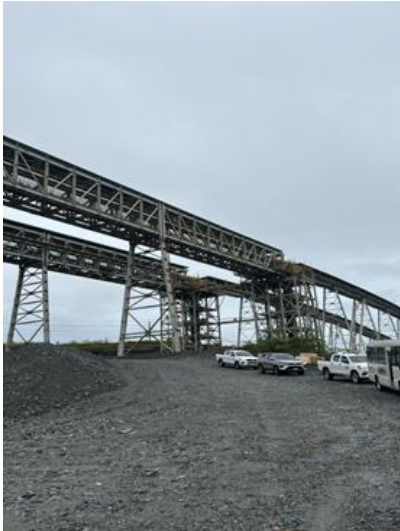
Fotografía 7-17 Cruce de bandas transportadoras
