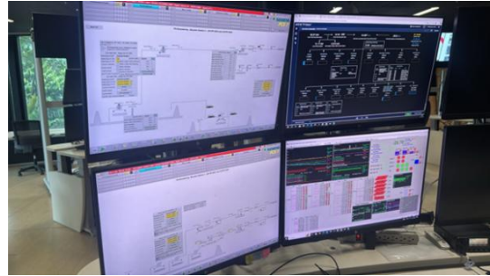
Fotografía 7-70 Pantallas sistema SCADA Siemens PCS7 y AVEVA PI Visión
