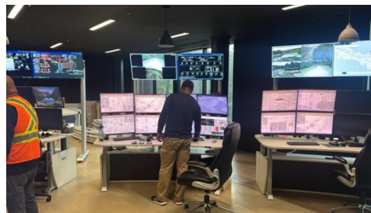
Fotografía 7-71 Estaciones de trabajo del centro de control
