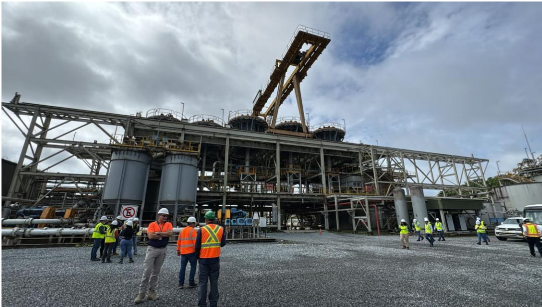
Fotografía 7-35 Vista general centro de ciclonado
