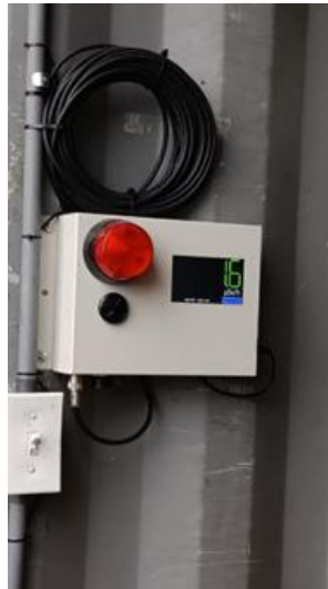
Fotografía 7-68 Contador de radicación para el seguimiento y control del almacenamiento
