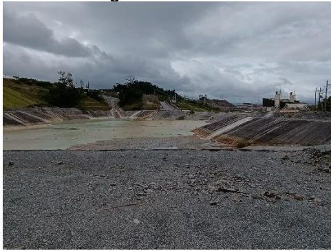
Manejo de aguas de contacto, deposito principal, nótese la planta de cal viva.
