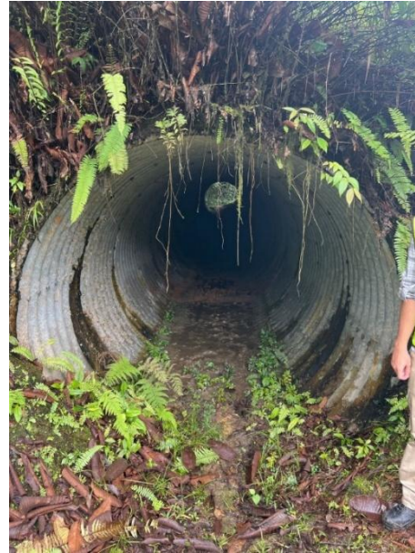
Fotografía 7-113 Paso terrestre de fauna
